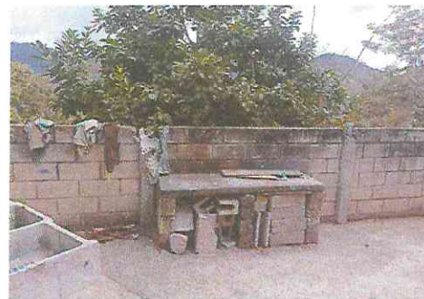
Foto 4: Muro en mal estado y con necesidad de remozamiento.
